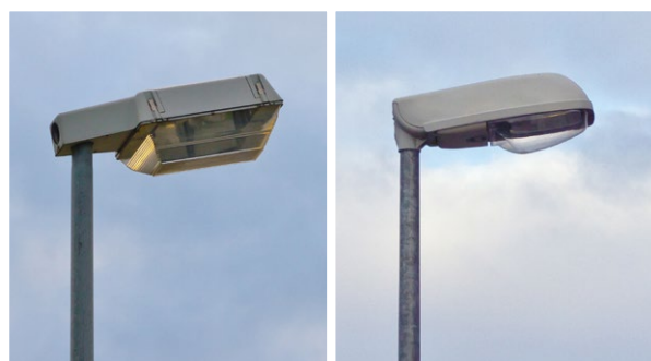
Durch die schräge Montage und die gewölbte Abdeckwanne wird unnötiges Streulicht erzeugt.
